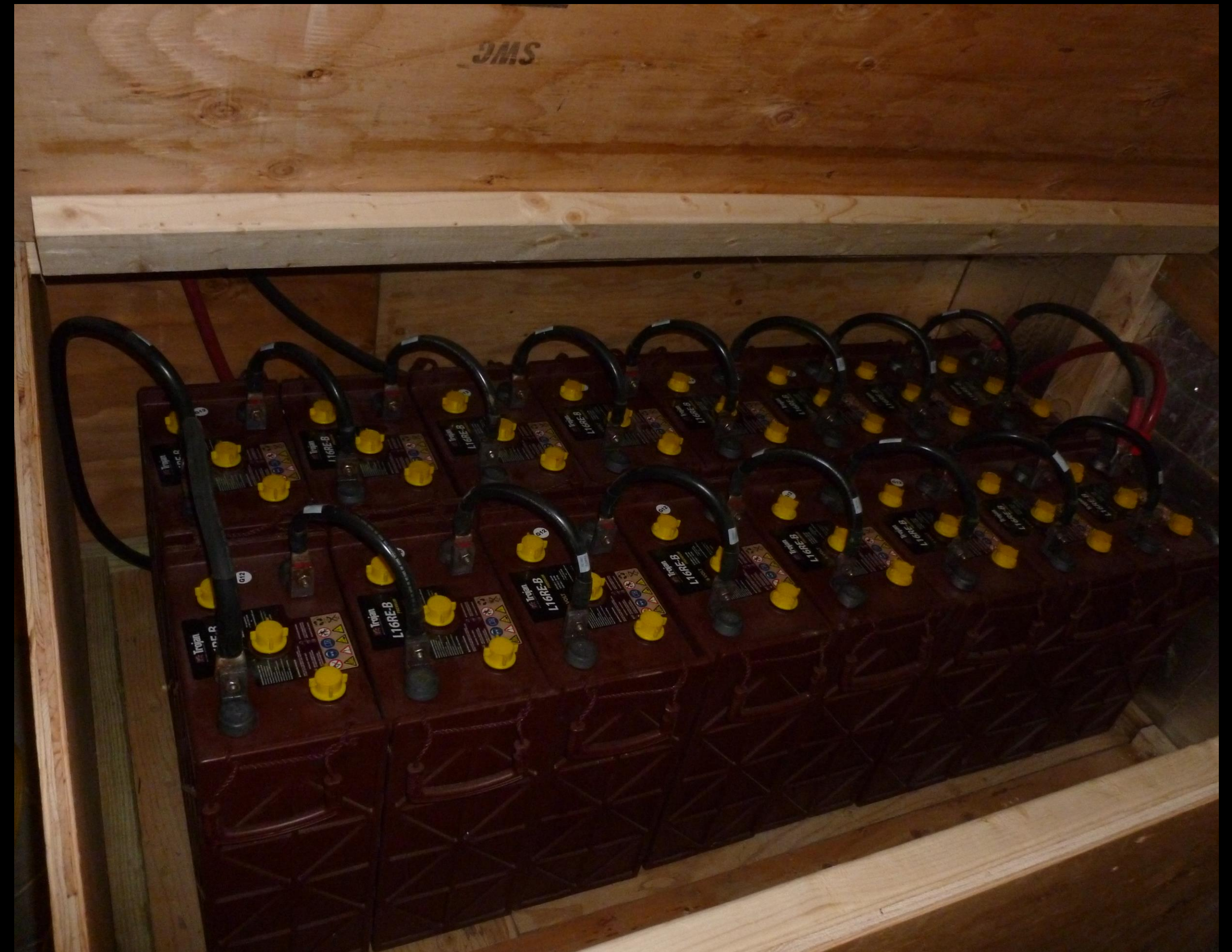
16 Trojan FLA Batteries (370Ah) 48 volt system
